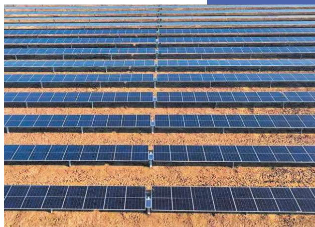
Impianto a terra Ferrara Potenza: 10.000kWp
