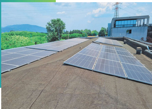
Impianto su capannone Brescia Potenza: 100kWp
